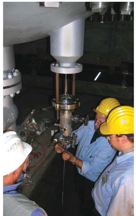
Instalación de un termopar multipunto
